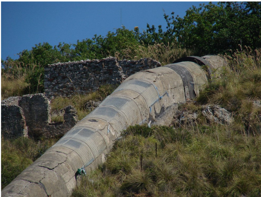
Foto 2 rotture condotto fumi conterminata
